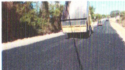
Foto 181 – Saçamento de via.
