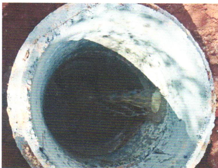
Figura 11 - Esgoto chegando no PV final
