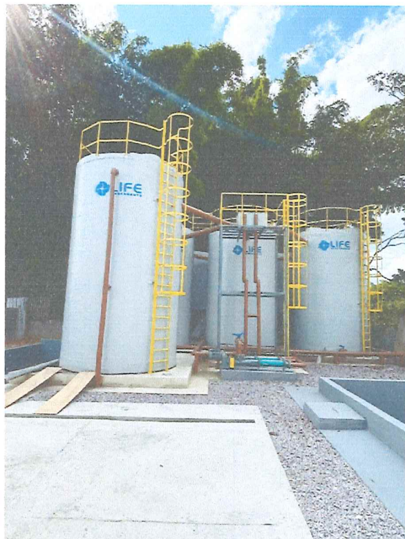
Figura 1 – Visão geral ETE montada
