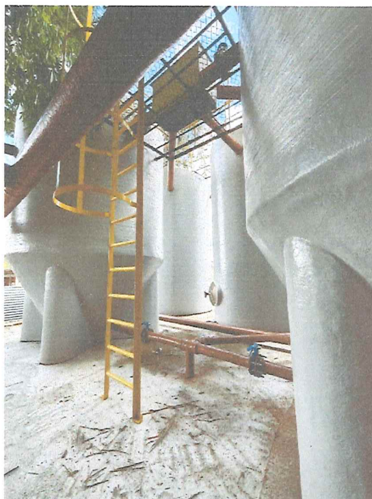
Figura 2 - Vista interior da ETE
